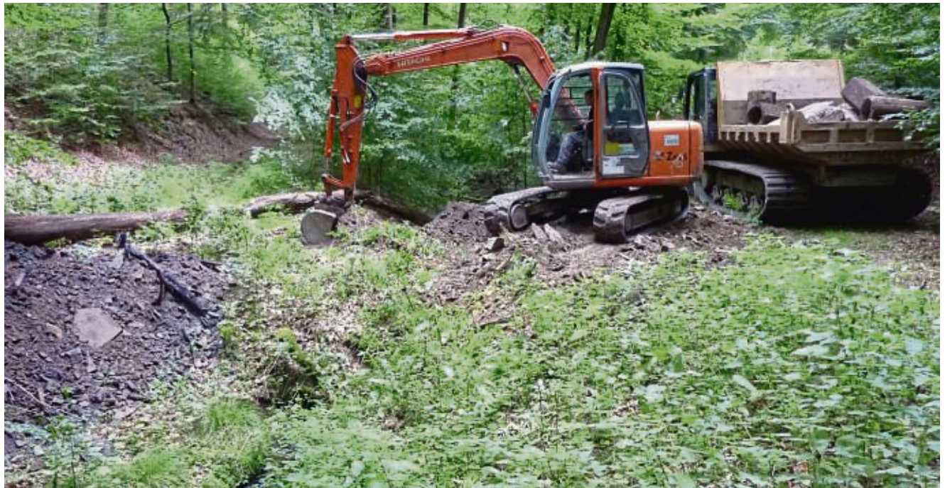
Bagger im Einsatz: Arbeiten zur Renaturierung von Gewässern im Nationalpark erfordern manchmal auch schwere Gefährte, dabei wird immer so behutsam wie möglich vorgegangen.
