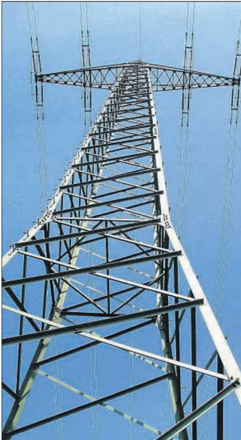
Erster Schritt: Tennet hat einen Antrag bei der Bundesnetzagentur eingebracht. Foto: nh
