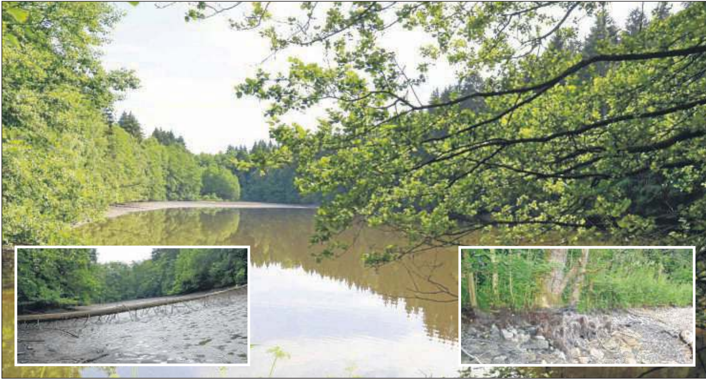
Wohrateiche: Das große Bild zeigt den oberen Teich mit reduziertem Wasserstand. Das Bild links entstand am unteren Teich, wo teilweise der Boden zu sehen ist. Das Bild rechts zeigt einen großen Baum, der die Festigkeit des Damms gefährdet. Fotos: Biedenbach
